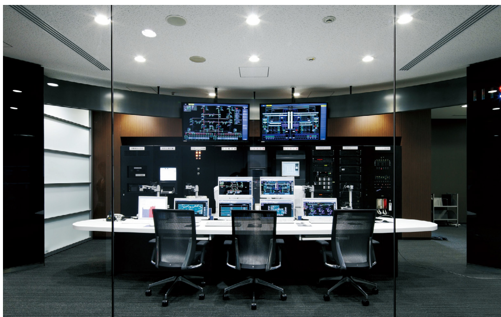
Tokyo Data Center I
